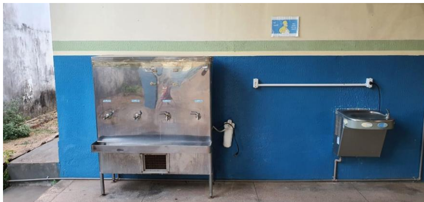
Figura 23. Bebedouros localizados no pátio do CMAL. Serão fixados cartazes com orientações sobre o uso adequado e dispenser com papel para acionamento das torneiras em caso de necessidade.
