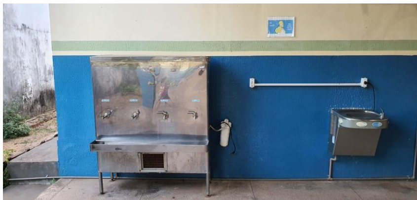
Figura 22. Bebedouros localizados no pátio do CMAL. Serão fixados cartazes com orientações sobre o uso adequado e dispenser com papel para acionamento das torneiras em caso de necessidade.
