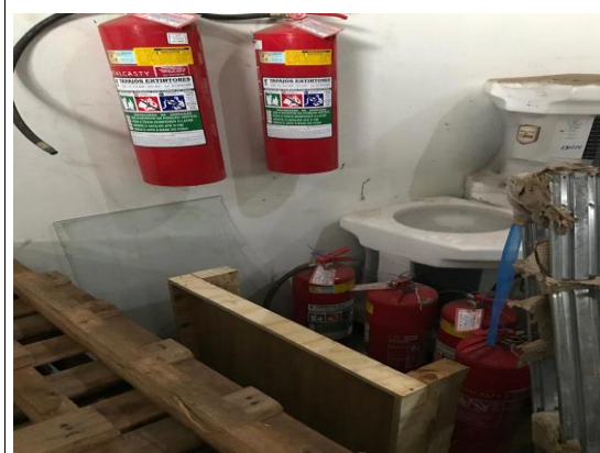
Imagem 9. Obstrução de acesso aos extintores de incêndio no interior do Almoarifado (16.05.2019)
