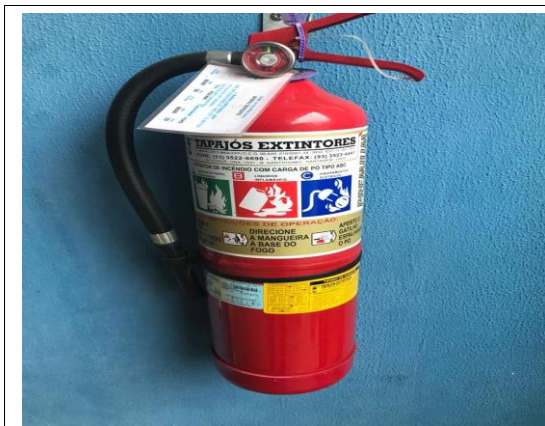
Imagem 7. Extintor Classe ABC localizado na entrada do Almoarifado (16.05.2019)
